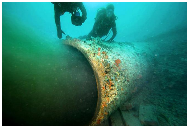
Figura 34 – Descarga de efluentes para o mar.
